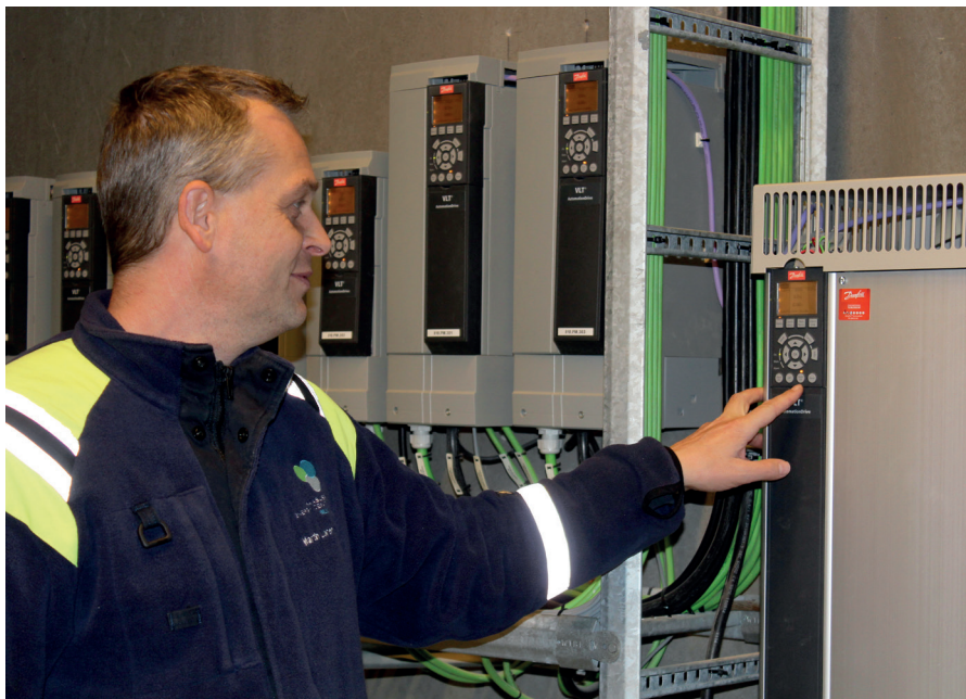
Elektriker Martin Lorentzen vid en 45 kW VLT® AutomationDrive FC 302 frekvensomriktare.
