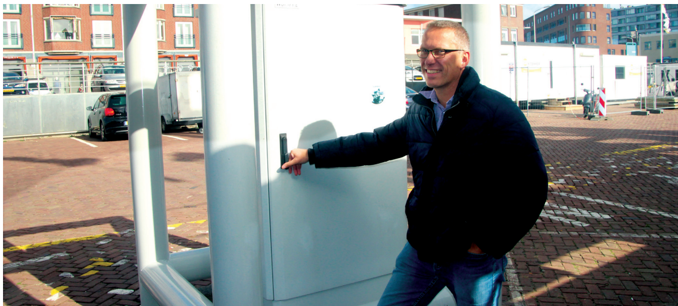
Maarten Hektor demonstreert een van de walstroomaansluitpunten, die worden aangestuurd door de Walstroom-app van Involtum.
