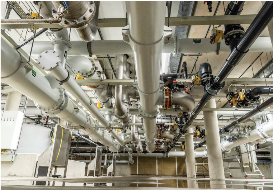
De leidingen en apparatuur zijn alle aan het plafond bevestigd of op sokkels geplaatst, zodat bij een onverhoopte lekkage het proces doorgaat.
