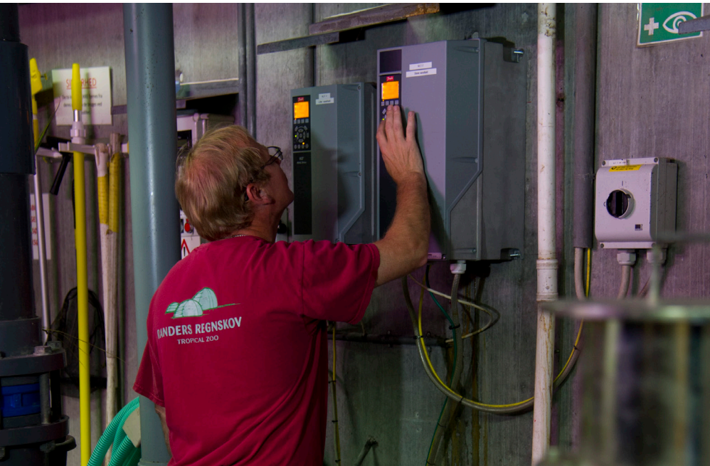
Teknisk chef Peter B. Jensen bruger ikke meget energi på at kontrollere sine Danfoss frekvensomformere. Dem er der aldrig problemer med, siger han.
