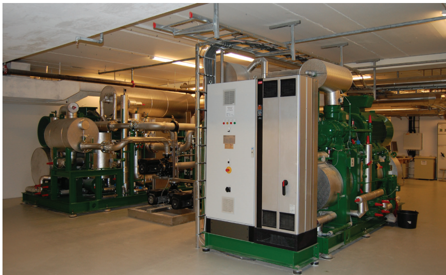
To 355 kW VLT® HVAC Drives FC 102 IP 54 frekvensomformere styrer skruekompressorerne, som gør det muligt for de to GEA Grenco varmepumper, på 2400 kW, at justerer varmen fra lav til høj præstation med den samme effektivitet.
