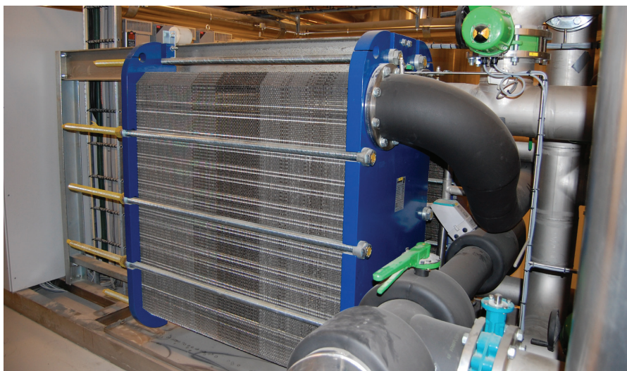
Det afkølede vand fra varmeveksleren cirkuleres rundt i bygningen for at køle værelserne til den ønskede temperatur. Ingen aktiv køling er påkrævet.
