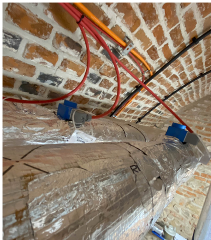
Elektrozawory zamontowane na jednej z sekcji instalacji obiektowej
