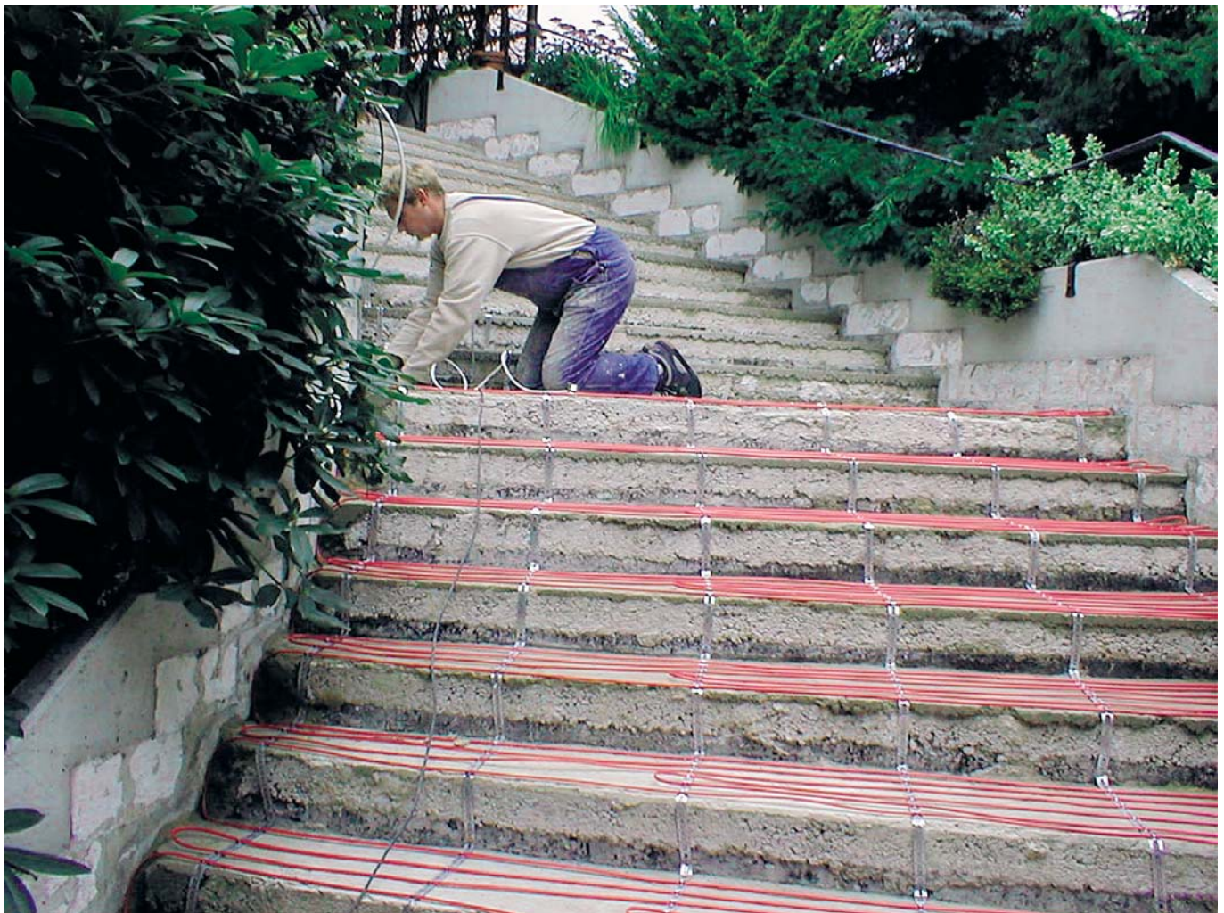
Система сніготанення на сходах
