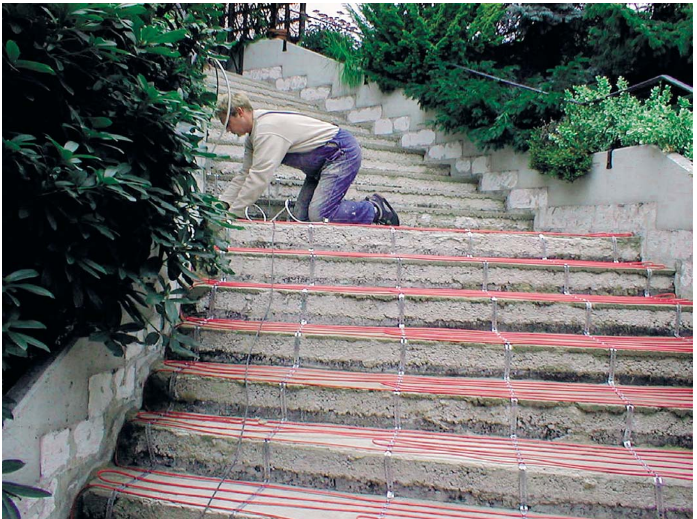
Система сніготанення на сходах
