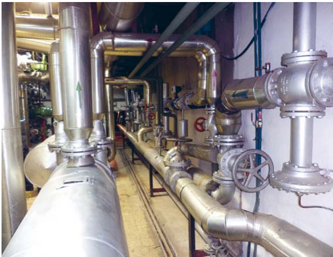
Тепловий пункт «СКПК Мейдан» до реконструкції
