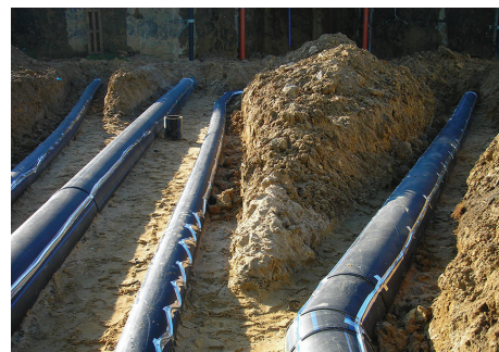
Rørledning i Strzelce Opolskie, Polen
