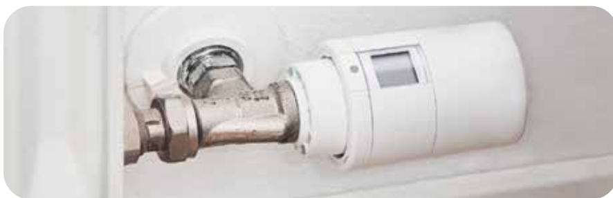
↑ In vier der Räume hat Familie Anker nun Danfoss Ally™-Heizkörperthermostate installieren lassen.
