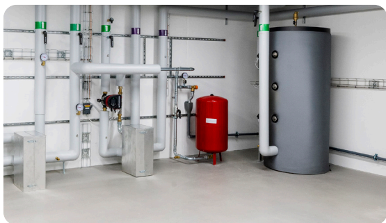
Acqua calda sanitaria
