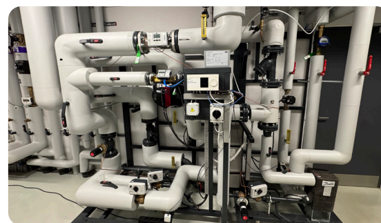
Sottostazioni a basamento
