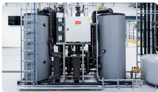
Centraler för värmeåtervinning/Heat Recovery Units
