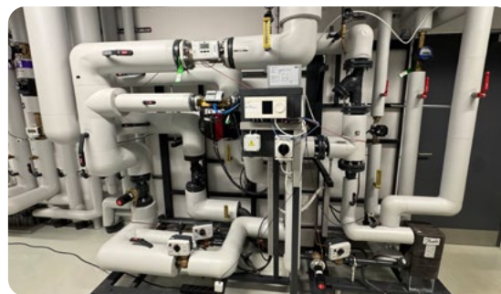
Блочні теплові пункти
